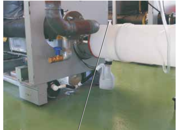
Messöffnung an der Kondensatfalle
